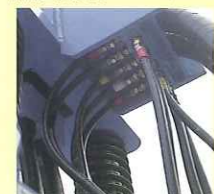
偏心モーメント制御配管部
