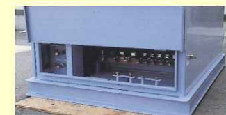
一次側キャブタイヤ取付部
